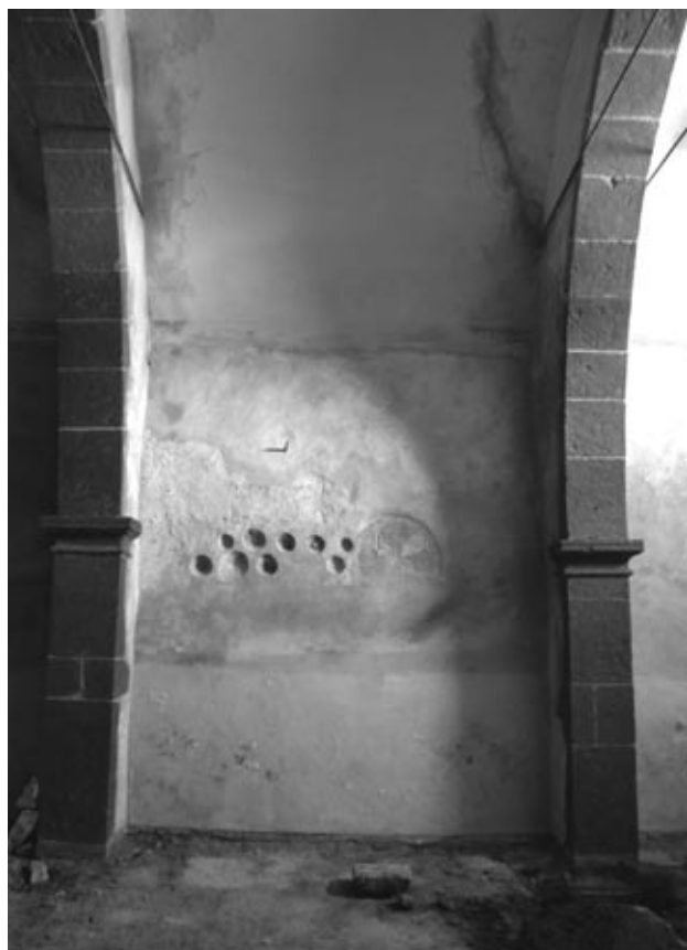
Fig. 3 – Visione generale del complesso dei bacini ceramici presenti sul prospetto interno del perimetrale Sud (foto M. Milanese).
